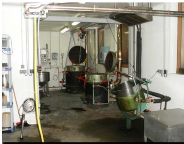
Salle de transformation de l'atelier Crédit photo : G. WAGNER
