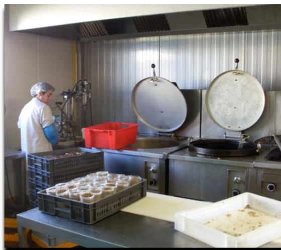
Salle de transformation chaude Crédit photo : G. WAGNER
