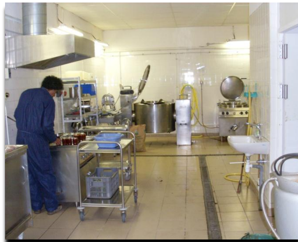
Salle de transformation Crédit photo : G. WAGNER
